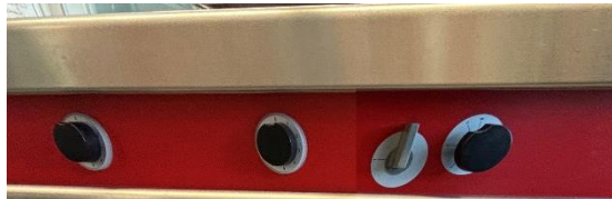
Bedienelement Posten 5-6 (2 Induktion und 1 Gas)
